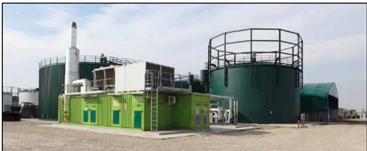
Un impianto per la produzione di energia elettrica a biomasse a Vigarano Pieve
