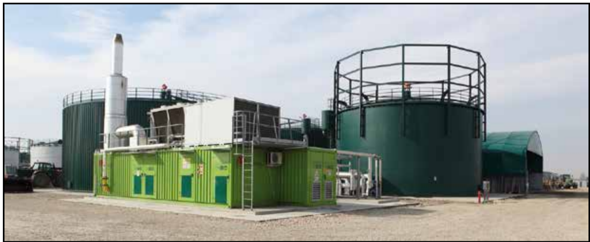
Un impianto per la produzione di energia elettrica a biomasse a Vigarano Pieve
