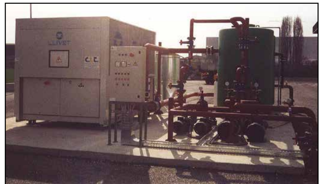
Un particolare impianto acqua refrigerata ubicato a Bondeno
