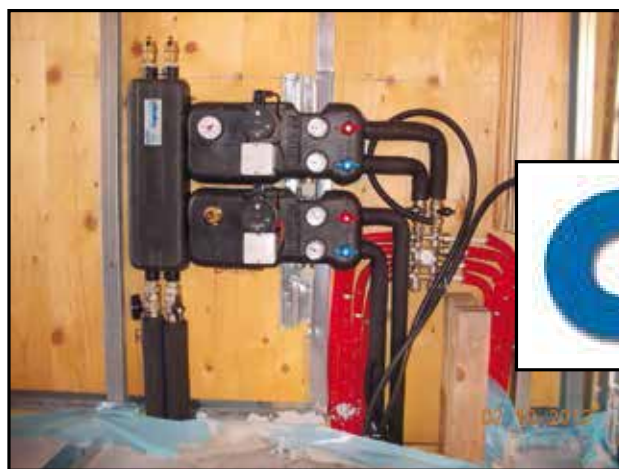
Centro Maria Regina Della Pace, Bondeno Impianto alta e bassa temperatura
